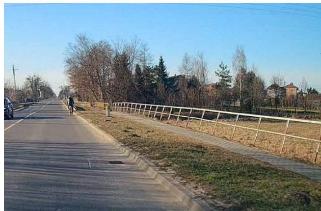
Zdjęcie 30: Błędne użycie ogrodzenia „U-12” zamiast „U-11a”. oraz niestabilny montaż istniejącego ogrodzenia. Źródło: własne.
