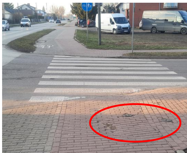
Zdjęcie 52: Zapadnięta kostka betonowa przy zaworach wodociągowych. Źródło: własne.
