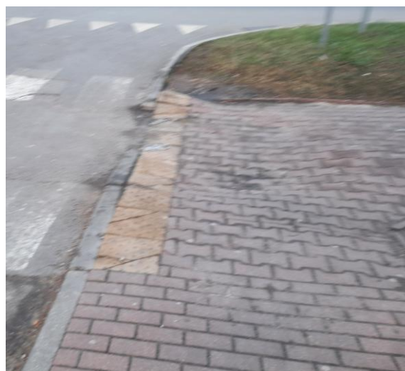
Zdjęcie 54: Uszkodzona strefa oczekiwania na przejściu dla pieszych. Źródło: własne.
