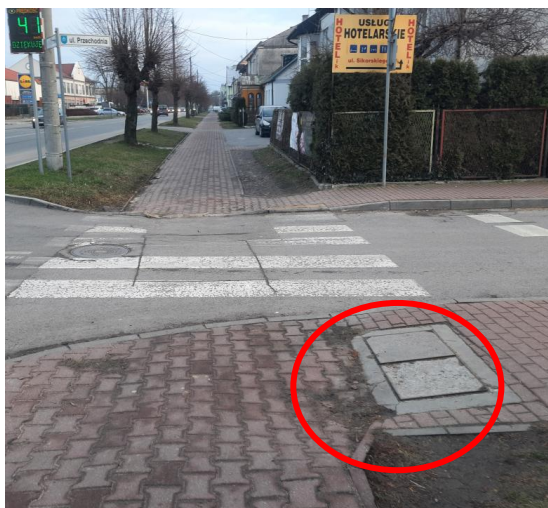
Zdjęcie 51: Zapadnięta studnia telekomunikacyjna. Źródło: własne.
