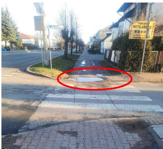
Zdjęcie 53: Uszkodzona strefa oczekiwania na przejściu dla pieszych. Źródło: własne.
