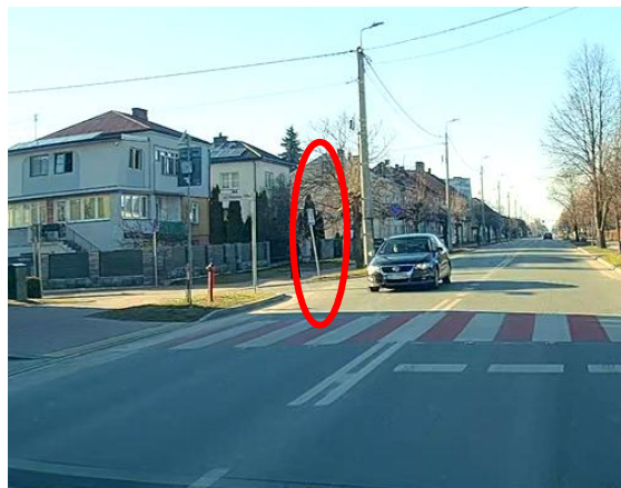
Zdjęcie 21: Krzywy słupek znaku D-6 „przejście dla pieszych”. Źródło: własne.
